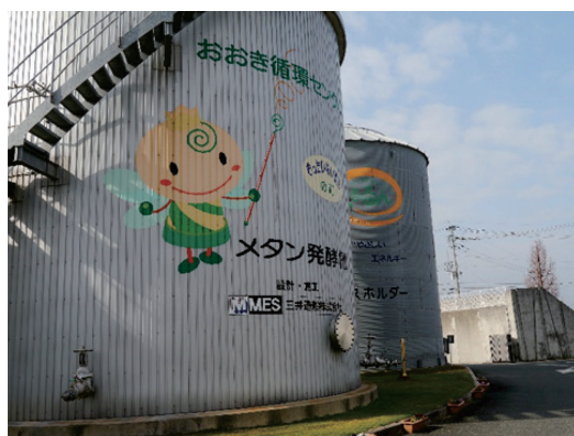
図4 メタン発酵槽
