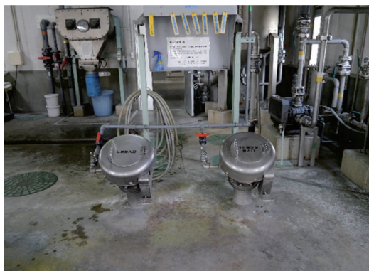
図3 し尿・浄化槽汚泥投入口
